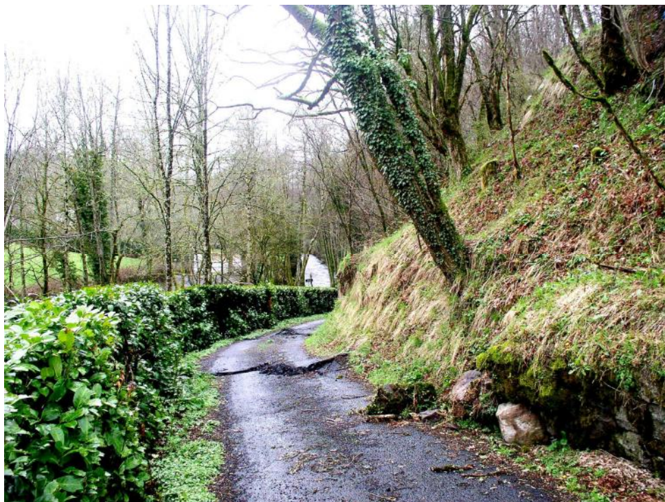
Illustration 6 - Bourrelet frontal du glissement déformant la chaussée d'un chemin communal situé sous la RD 990 en avril 2008 (photo BRGM)
