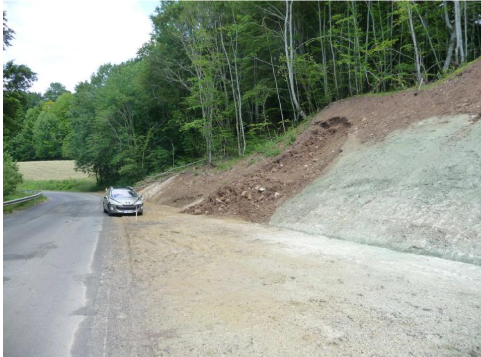
Illustration 9 - Glissement superficiel dans les argiles vertes de l'Oligocène dans un talus de déblai de la RD 600 (photo BRGM, juillet 2010)
